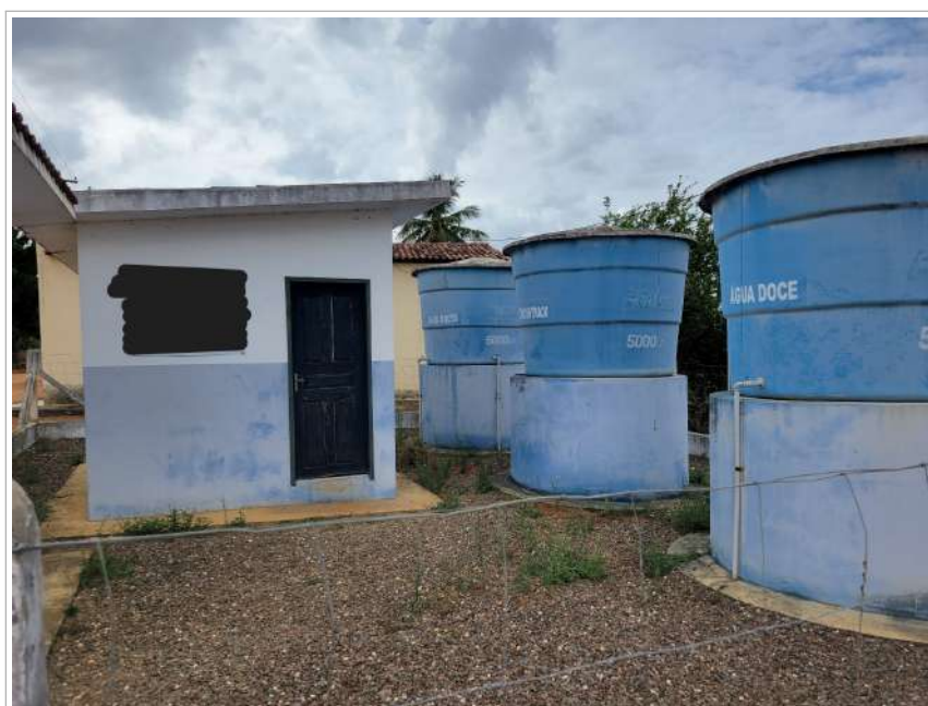
Figura 9 – Reservatórios de uma estação de dessalinização do Programa Água Doce: água bruta, concentrado e água doce.
